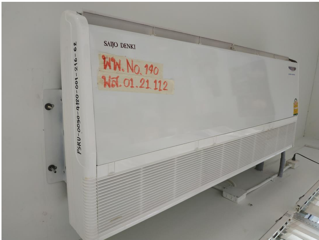
เครื่องปรับอากาศ ขนาด 36000 BTU PSRU-0050-4120-001-216-62 ห้อง กอ.306
