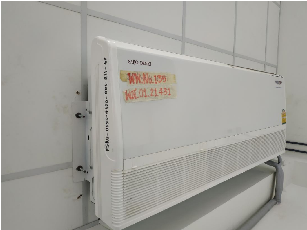
เครื่องปรับอากาศ ขนาด 36000 BTU PSRU-0050-4120-001-211-62 ห้อง กอ.207
