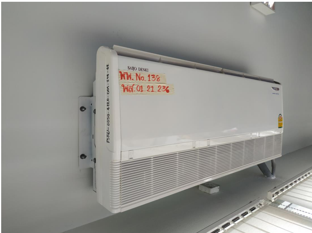
เครื่องปรับอากาศ ขนาด 36000 BTU PSRU-0050-4120-001-214-62 ห้อง กอ.302
