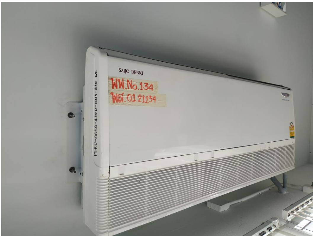
เครื่องปรับอากาศ ขนาด 36000 BTU PSRU-0050-4120-001-210-62 ห้อง กอ.302
