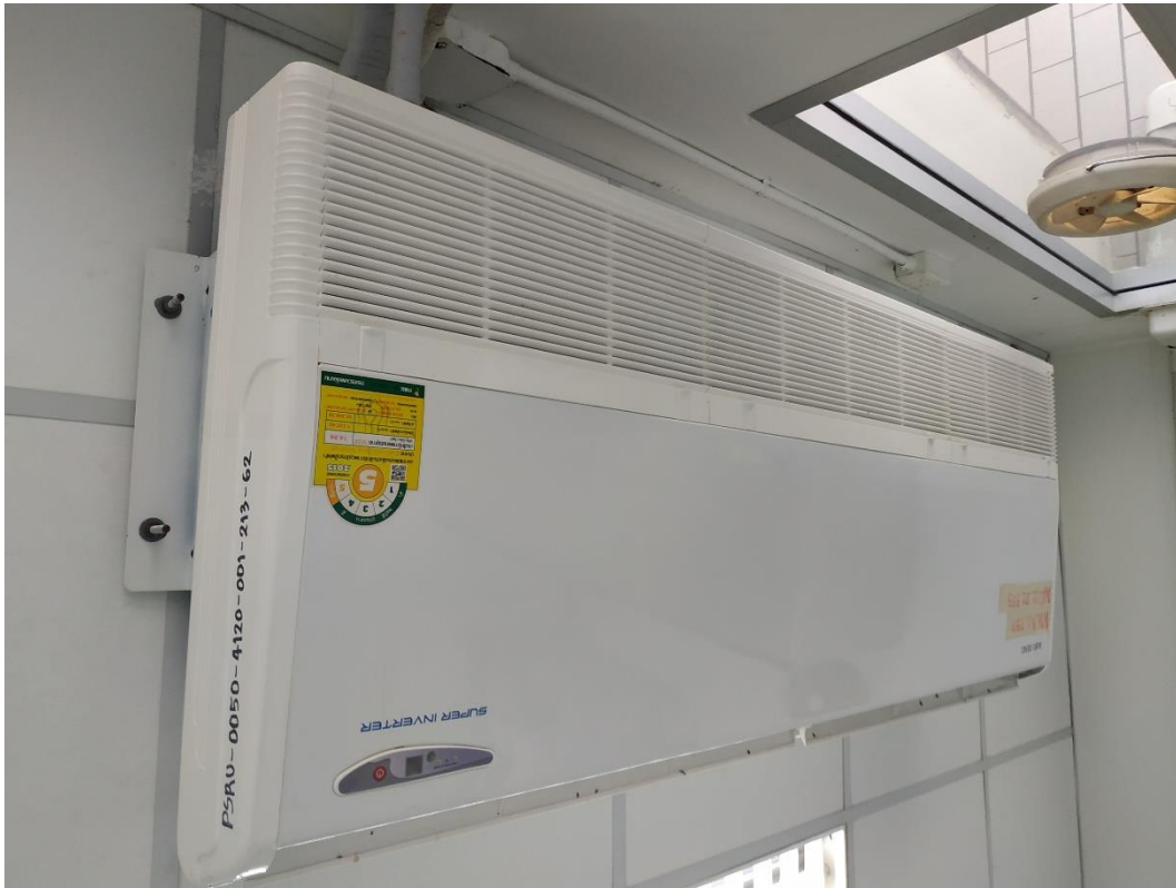
เครื่องปรับอากาศ ขนาด 36000 BTU PSRU-0050-4120-001-213-62 ห้อง กอ.208
